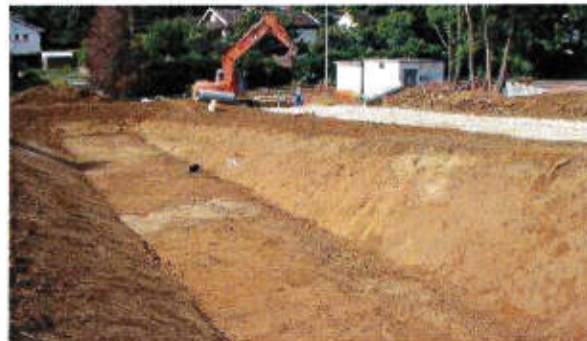
Exemple de mise en place d'un bassin de rétention des eaux pluviales
